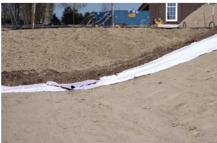
Pose de terre sur un géotextile de protection/séparation sur le TRISOPLAST compacté.
