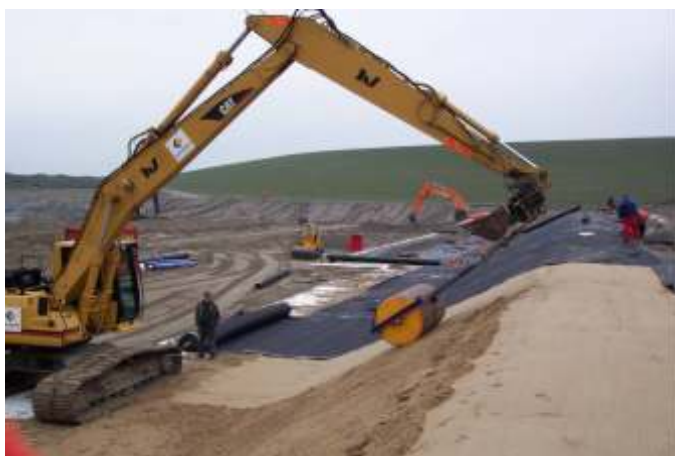
Compactage du TRISOPLAST sur talus d'une barrière de fond dans un Centre d'Enfouissement Technique.
